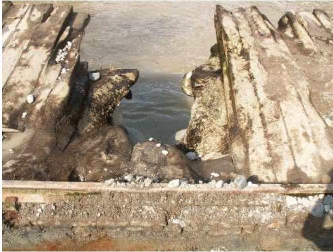
Das Ausmaß des Schadens aus der Nähe.
