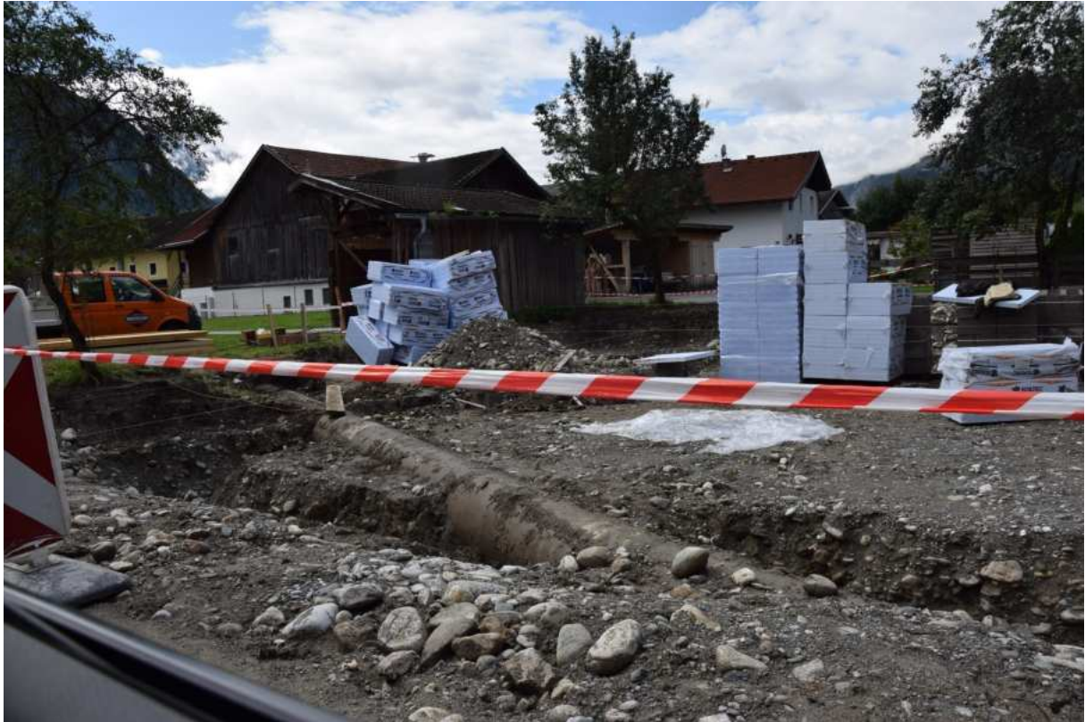
Aufnahme 9. September 2019 – Anscheinend ohne Baugenehmigung wollte der Besitzer ein Haus auf den Mühlwaal bauen. Gut ersichtlich die Rohrleitung des Mühlwaales.
