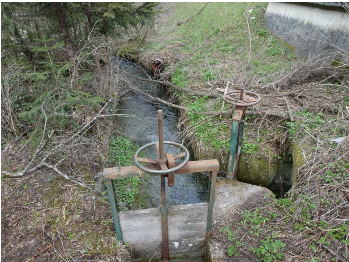
10. April 2018 - Der Schieber im Vordergrund reguliert den Zufluss in den Tragwaal (1.014 l/s), der Schieber rechts den Zufluss in den Mühlwaal (100 l/s).
